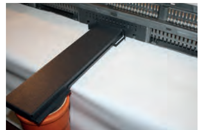
KG-Rohr DN 100 kann angeschlossen werden
