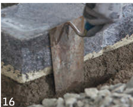
16 Der Beton muss einseitig bzw. beidseitig zu späteren Pflasterflächen hin abgestochen werden, um einen gleichmäßigen Aufbau des Unterbaus zu gewährleisten. Sollen die angrenzenden Flächen der freistehenden Mauer unbefestigt hergestellt werden, ist auf der betreffenden Seite jeweils eine Rückenstütze herzustellen.
