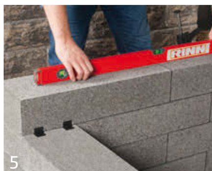
5 Überprüfen Sie Stein für Stein die Flucht in allen Achsen, horizontal und vertikal über die ganze Mauer hinweg
