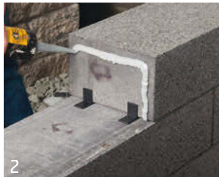
2 Tragen Sie auf den Kopfseiten den Kleber U-förmig mit ca 2 cm Abstand zum Steinrand auf. So wird die Fuge geschlossen.
