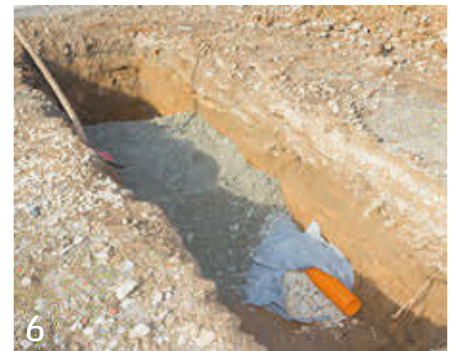
6 Lagenweise (30 cm) Schotter 0/32 oder 0/45 einfüllen und verdichten. Auf ausreichende Wasserdurchlässigkeit ist zu achten.
