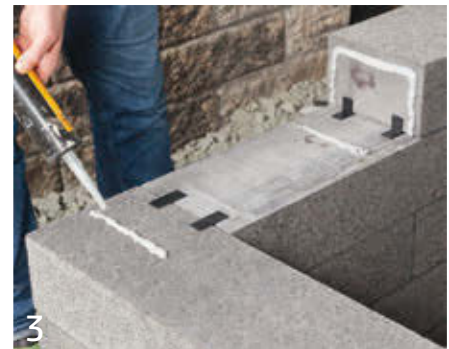
3 Arbeiten Sie beim Setzen der Abdecksteine im Übrigen wie bei den Mauerreihen.
